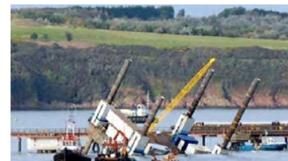
圖3. 傳統使用腿樁站立之海上工作平台易因海床鬆軟或沉陷造成傾塌之意外事件
